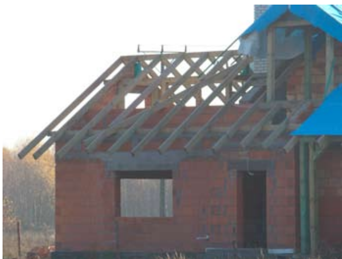
fot. 1. Więźba dachowa jest zaliczana do II klasy zagrożenia drewna, jednak ponieważ przez część czasu budowy jest narażona na warunki atmosferyczne, lepiej materiał traktować jak klasę III.
