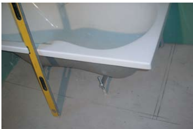
fot. 1. Po przystawieniu poziomnicy do krawędzi wanny - i prostopadle do podłogi - uzyskamy linię lica obudowy.
