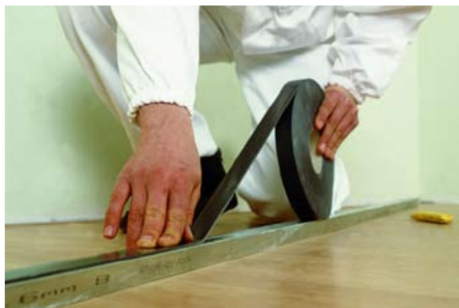
fot. 2. Wszystkie stykające się ze ścianami elementy stelaża trzeba podkleić taśmą izolującą akustycznie
