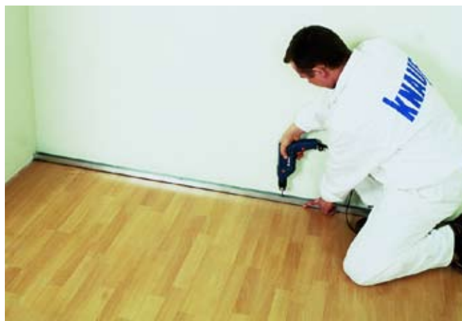
fot. 3. Profile składające się na stelaż obwodowy przykręca się do sufitu, podłogi oraz ścian.
