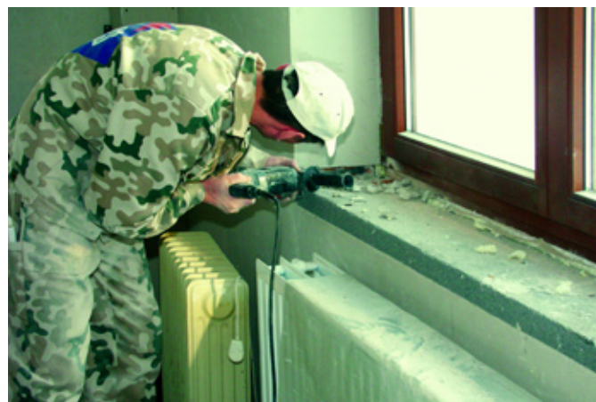
fot. 2. Podkucie ościeża jest jednym z ważniejszych etapów prac, musi też być wykonane precyzyjnie.
