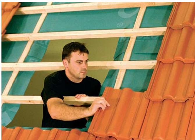
fot. 1. Prace związane z montażem okna dachowego zaczynają się od przygotowania odpowiedniego otworu w dachu.
