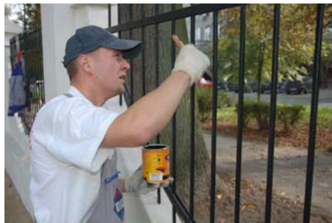
fot. 7. Także metalowe wypełnienia przęseł wymagają odnowienia - należy usunąć starą farbę, oczyścić ogniska rdzy i ponownie pomalować najpierw farbą antykorozyjną podkładową, a następnie farbą nawierzchniową.
