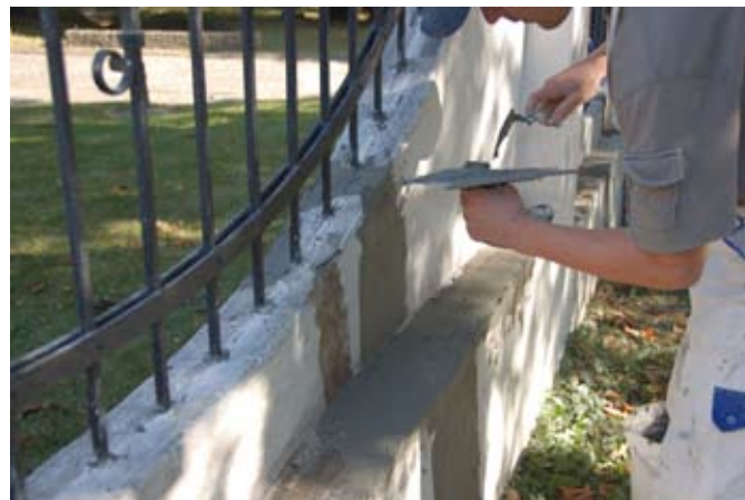
fot. 3. Ubytki w betonie należy starannie wypełnić zaprawą.
