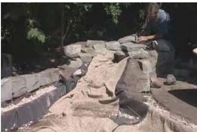
fot. 9. Strumyk powstał z ziemi wydobytej z wykopu; warto wyłożyć go folią imitującą kamienie.
