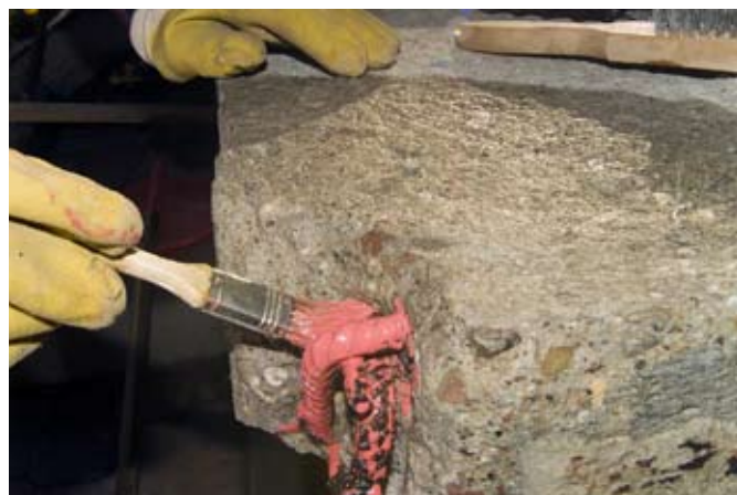
fot. 3. Zbrojenie warto jest zabezpieczyć farbą podkładową, choć w przypadku stosowania systemu naprawczego nie jest to niezbędne.
