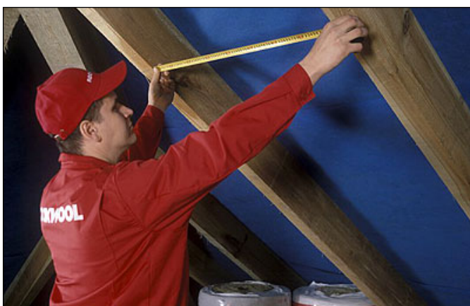
fot. 1. Konieczne jest zmierzenie rozstawu wszystkich krokwi, ponieważ często odstęp między nimi nie są identyczne.
